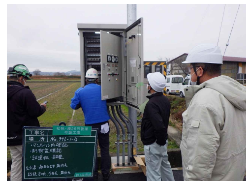
污水管渠（マンホールトップ制御盤） (南あわじ市)
