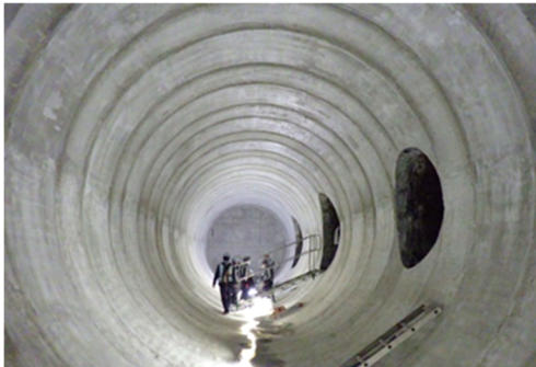
津門川地下貯留管
