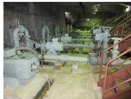
更新予定の配水ポンプ（稲美町）
