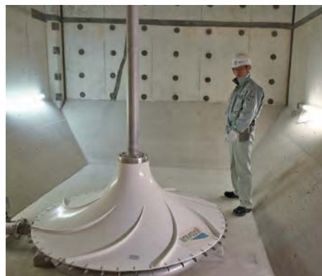
淡路市・津名浄化センター（攪拌機）
