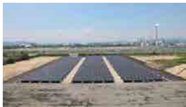
下水処理場の自家消費用太陽光発電設備
