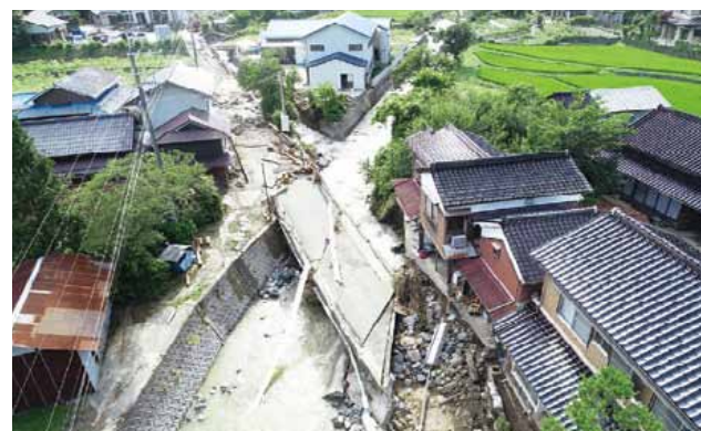
ドローンを活用した被災状況調査 （宍粟市：平成30年7月豪雨災害）
