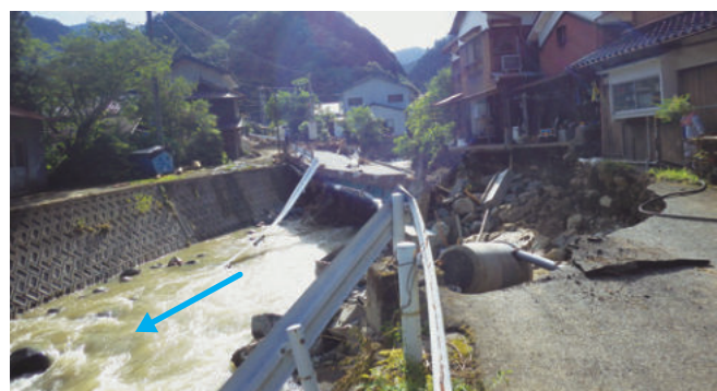
被災直後の椿下橋
