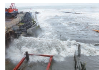
海水が仮締切矢板を越流
