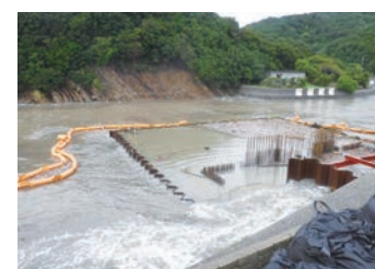
水没した仮締切
