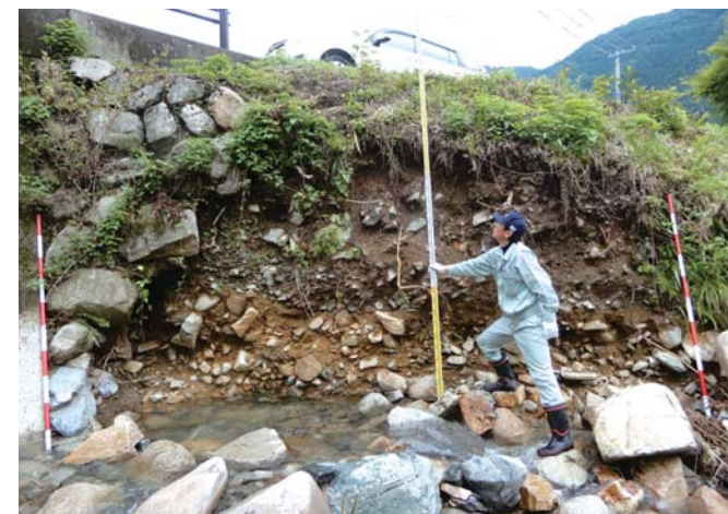
被災状況調査
