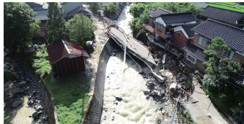
橋下橋の被災状況（ドローンから撮影）
