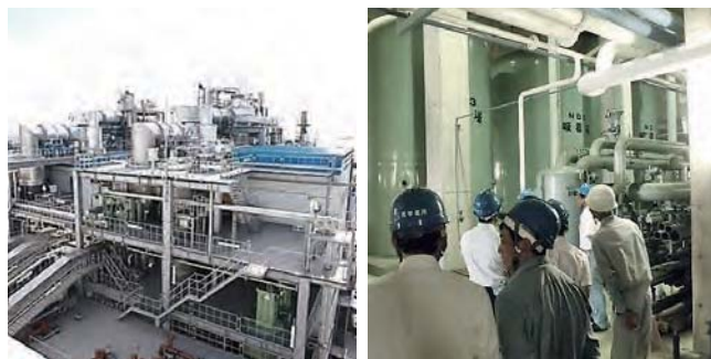
全国的に珍しい汚泥溶融処理設備と酸素発生設備
