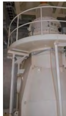
立軸斜流ポンプ
