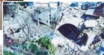
吐口側坑門の被災状況
