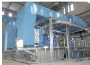
新しく増強されたポンプ
