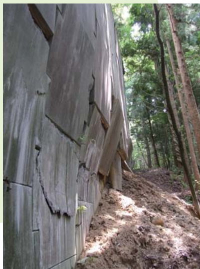
道路の被災状況（側面）
