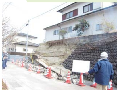
玉石空積擁壁の崩壊
