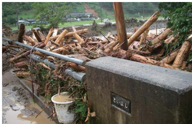
平成21年台風9号による被災状況(土肥橋に引っかかった流木)
