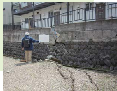
地滑りによる擁壁崩壊
