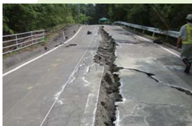
道路の被災状況
