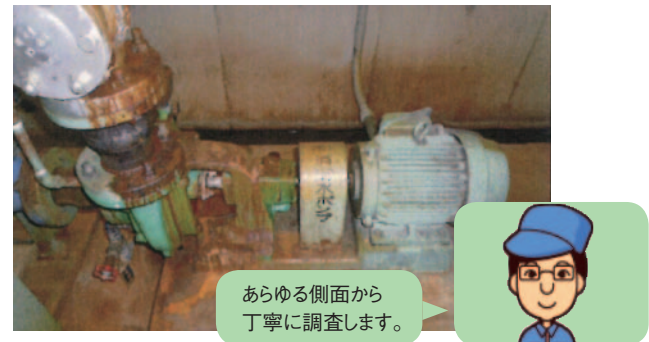
現地調査写真（一部）腐食及び塗装の一部剥離を確認
