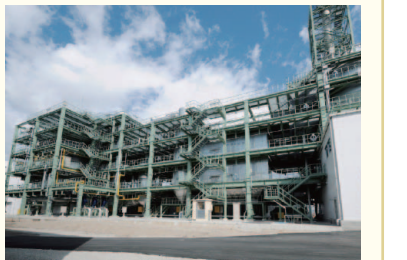
4号焼却炉（全景）
