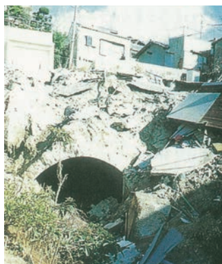
被災時(吐口側旧坑口1995年1月)
