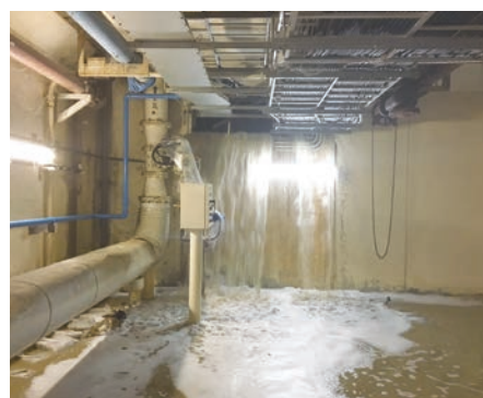
管廊壁面の開口部から滝のように流れ落ちる水
