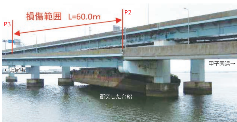
船舶が衝突した状況
