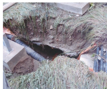
海水の侵入により発生した陥没
