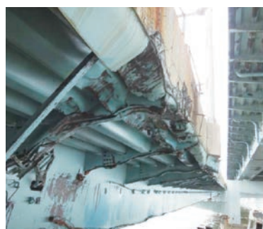
床版張出部の損傷状況
