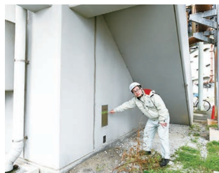
スラッジセンターの浸水痕（最大1m）
