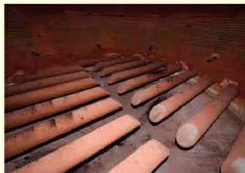
4号焼却炉内部
