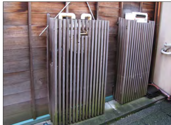
ガスメーター
