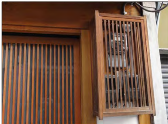
電気メーター
