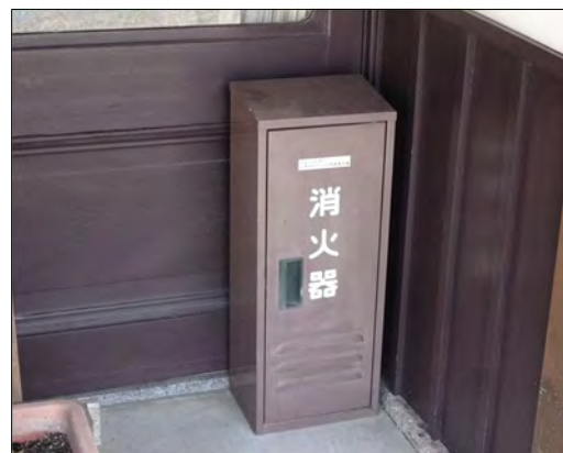
消火器ボックス
