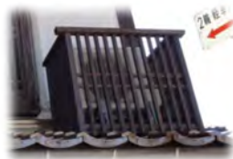
空調屋外機：目隠し
